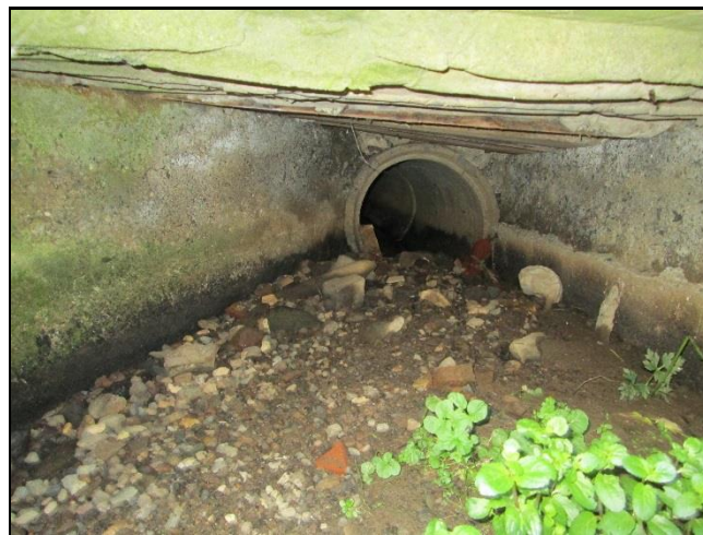
Abbildung 42: Bachverrohrung unter privater Scheune
