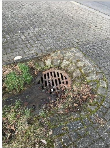
Abbildung 34: Einlaufrost, Grabenverrohrung Außengebiet West
